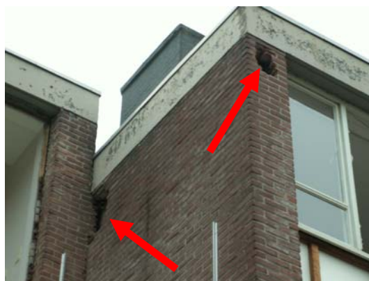
Foto 11 Gat in spouwmuur Valkenlaan
