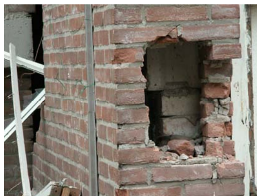
Foto 10 Gat in spouwmuur Valkenlaan
