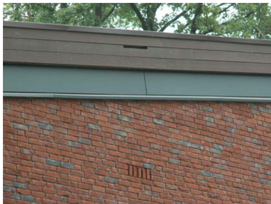
Foto 1 Zuidmuur blok 4 met rollaag en invliegspleet
